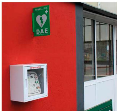
Le défibrillateur installé sur le mur d'entrée de la salle des fêtes
